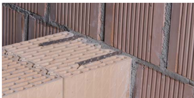
34. Hanggátló fal (25/30 AKU) és LeierPLAN elemekből falazott belső teherhordó fal csatlakozása bekötőszalaggal
